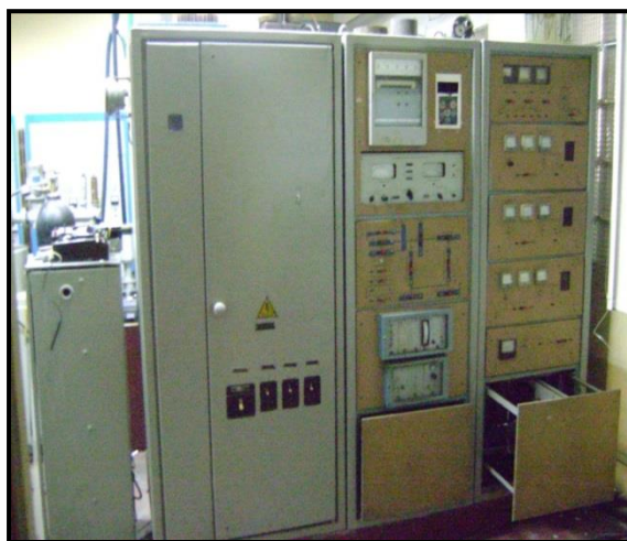
Рисунок 7. Общий вид шкафов управления вакуумной ионно-плазменной установки ННВ 6,6 – И1
